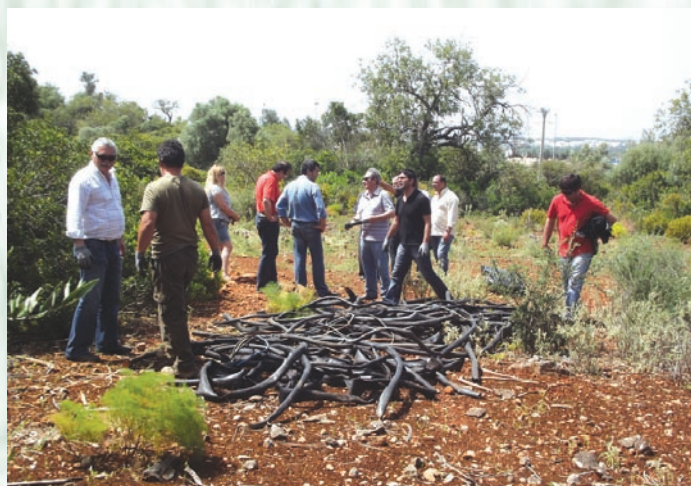
Revestimentos de cabos eléctricos deixados no terreno
